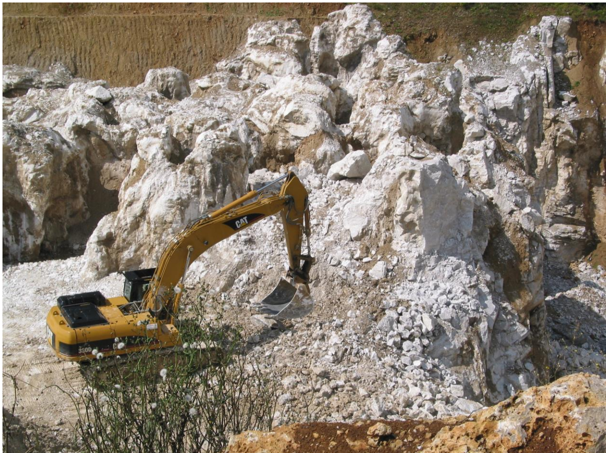
Abb. 5.5.2: Für den Abbau freigelegte stark verkarstete Gipsoberfläche in einem Abbau am Südharz.
