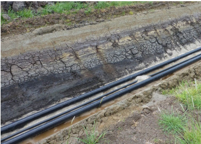
Abb. 12: Im Kabelgraben aufgeschlossener sulfatsaurer Böden (sulfatsaure Kleimarsch über Organomarsch) mit Jarositbildung. Unten Wechsellagerung mit Niedermoortorfen (Foto: Stadtmann, LBEG).
