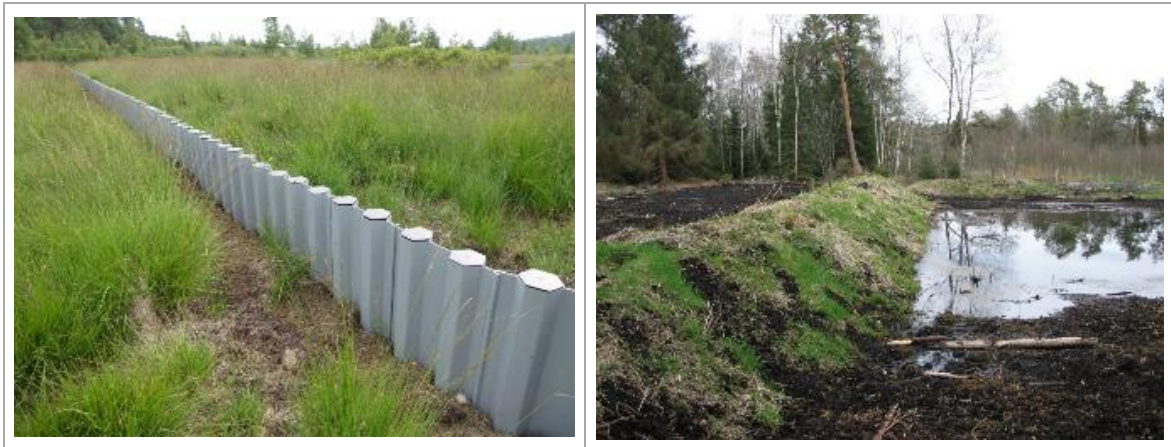
Abb. 4.11: Links: Hangparallele Kunststoffspundwand zum Auffangen des Oberflächenabflusses am Randgehänge. Hier fehlt die Torfabdeckung, die den Kunststoff vor UV-Strahlung schützt. Die Wände sind unnötig hoch und in dieser Form aus ästhetischen Gründen nicht gewünscht. Außerdem stellen sie ohne Torfüberdeckung eine Barriere für wandernde Tiere dar (NSG Heilsmoor, LK Osterholz; Foto: H.G. Kulp). Rechts: Spundwände werden meistens mit Torf zugedeckt, einerseits als ästhetischen Gründen und andererseits, um den Kunststoff vor UV-Strahlung zu schützen (Foto: J. Blankenburg).
