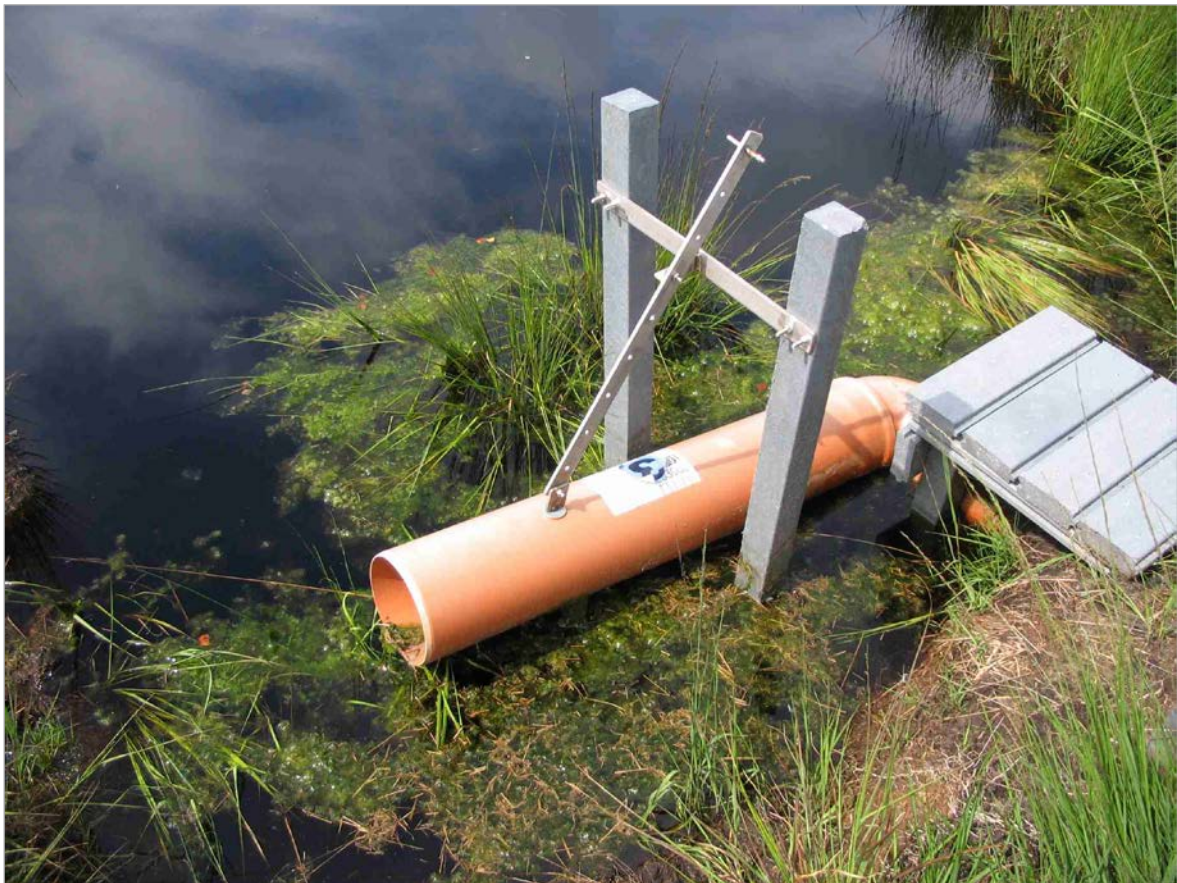
Abb. 4.15: Verstellbarer Überlauf im Leegmoor, Konstruktion der Staatlichen Moorverwaltung (Foto: J. Blankenburg).
