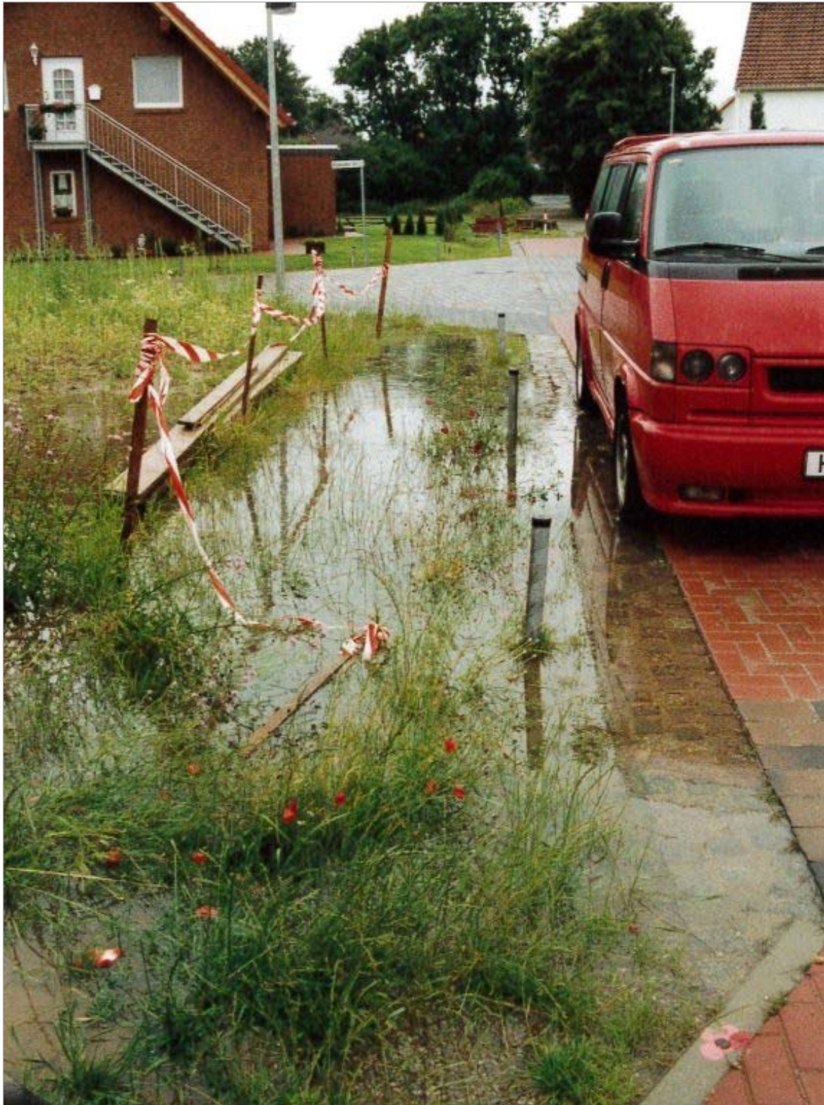
Abb. 7: Entwässerungsmulde, durch Bauarbeiten stark verdichtet. Keine Versickerung möglich (Foto: U. Hammerschmidt).
